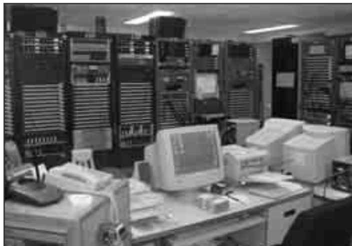
Régie centrale audio située au 2 e sous-sol de l'Hôtel du Parlement. Elle gère tous les signaux sonores venant des diverses salles de l'Assemblée nationale. C'est également à partir de cette régie que ces signaux sont émis aux diverses clientèles comme aux médias. Photo : Pierre Vallière, Assemblée nationale
