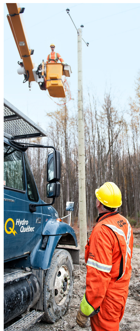
En 2015, 675 km de lignes ont été ajoutés au réseau de distribution, qui en compte maintenant 116 258.
