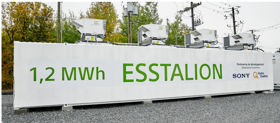
Technologies Esstalion est une coentreprise d'Hydro-Québec et de Sony (Japon) qui a mis au point un système de stockage de grande capacité capable d'accumuler 1,2 MWh d'énergie.
