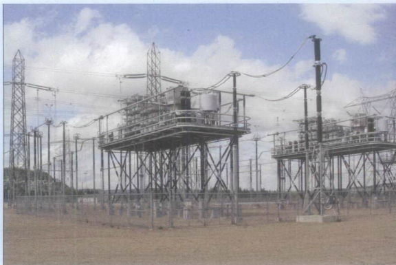
Le poste de Bergeronnes prend maintenant en charge de nouveaux mégawatts, par exemple ceux de la centrale de la Toulnostouc.
