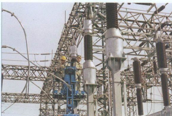
Le poste de Mercier, prêt à satisfaire les nouveaux besoins d'exploitation.
