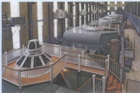
À la centrale de La Tuque, tous les groupes turbines-alternateurs font l'objet d'une réfection qui se terminera en 2008.
