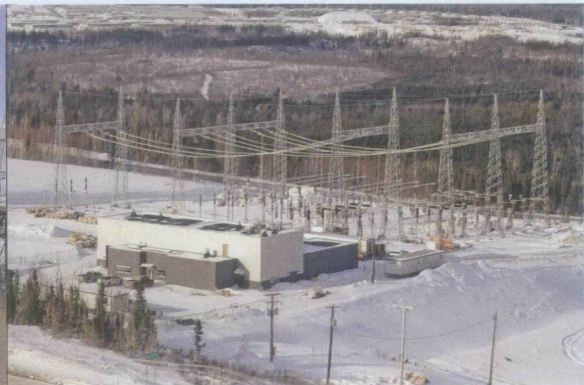
Poste de la Nemiscau. Une ligne à 315 kV le reliera à la centrale de l'Eastmain-1.
