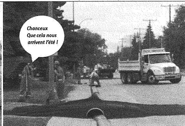
Protection de la tuyauterie à Prince-Albert (City.PA)
