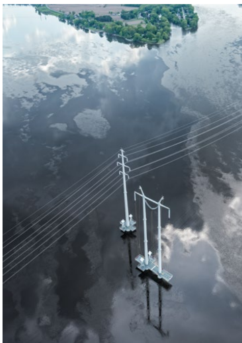
Section d'une ligne du projet de la Chamouchouane–Bout-de-l'Île traversant la rivière des Prairies, au nord-est de Montréal.
