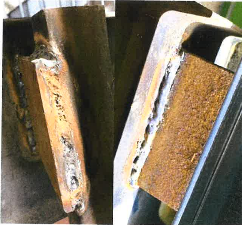
Figure 7 – Soudures poteaux trouvées aux étages 1 (image de gauche) et 4 (image de droite) de la même cage d'escalier associée à l'incident
