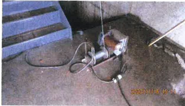
Figure 11 — Treuil électrique installé sur la dalle de béton du niveau 6 et utilisé pour le levage des pièces lors du montage de l'escalier n° 1
