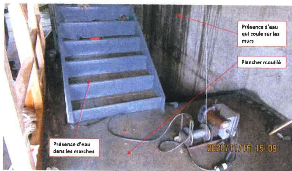
Figure 23 — Photo de l'escalier n° 1 au niveau 6 qui montre les conditions environnementales présentes le jour de l'accident
