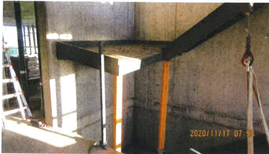
Figure 3 -- État du palier et des volées le lendemain de l'incident, soit le 17 novembre 2020. Les colonnes orange ont été ajoutées pour sécuriser le palier et la volée no 1.
