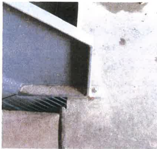
Figure 16 — Exemple d'un ancrage installé à l'extrémité d'une volée d'escalier inférieure
