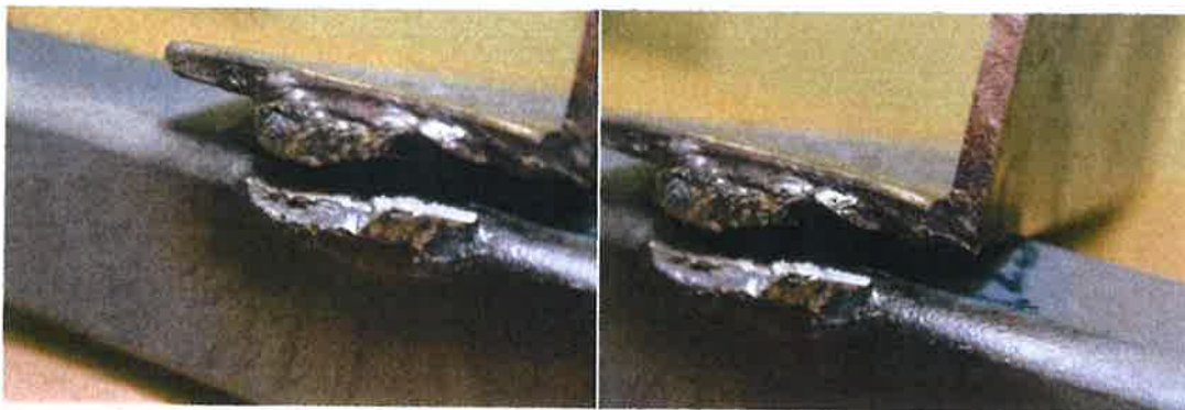
Figure 27 — Photos de la soudure impliquée dans l'accident
