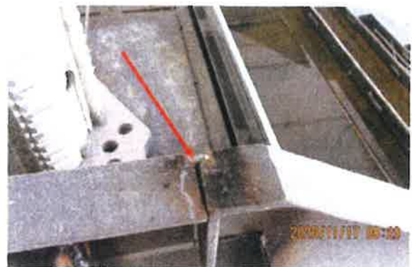
Figure 13 — Exemple d'un point de soudure entre le palier intermédiaire et la volée d'escalier inférieure
