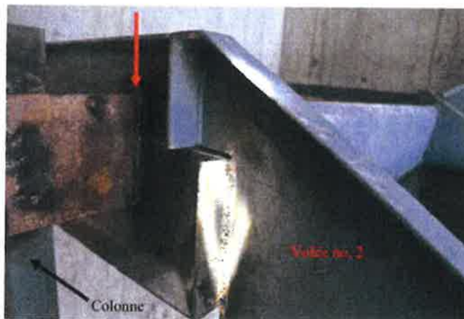
Figure 2 – Support permanent typique (plaque) soutenant l'extrémité du palier ne pouvant pas être maintenu par les murs de béton de la cage d'escalier (la flèche rouge illustre l'orientation de la force que la colonne devait supporter)
