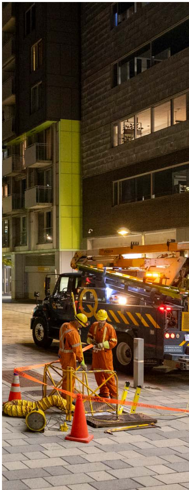
Une équipe de dépannage manœuvre un interrupteur dans une chambre souterraine du centre-ville de Montréal à la suite d'un appel d'urgence.
