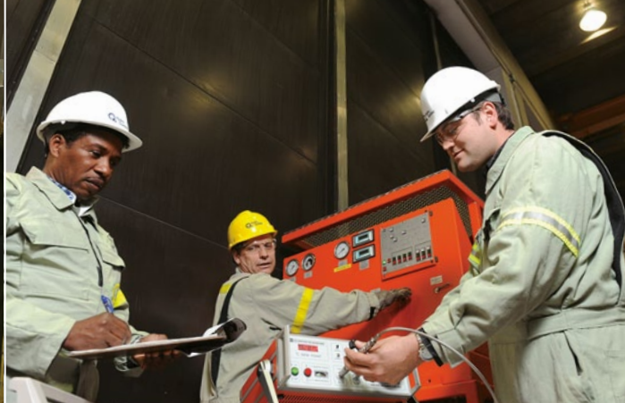
Les transformateurs du poste de Langelier, à Montréal, sont isolés à l'hexafluorure de soufre ( \text{SF}_6 ). Luckner Verna, technicien – Soutien technique, Jean-Luc Gadoua, chef électricien d'appareillage, et Mathieu Lalonde, ingénieur électrique, utilisent un hygromètre et un système de récupération pour vérifier la qualité du \text{SF}_6 .
