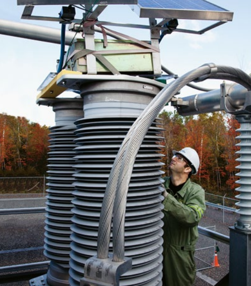
Au poste des Hêtres, à Shawinigan, le technicien Pierre Fafard inspecte le CapThor, un nouveau dispositif de protection de la batterie de condensateurs.
