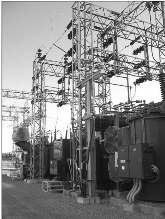
Vue des trois premiers transformateurs à l'intérieur de l'enceinte
